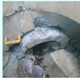
地震により破損した下水道管(北海道胆振東部地震(2018年))
