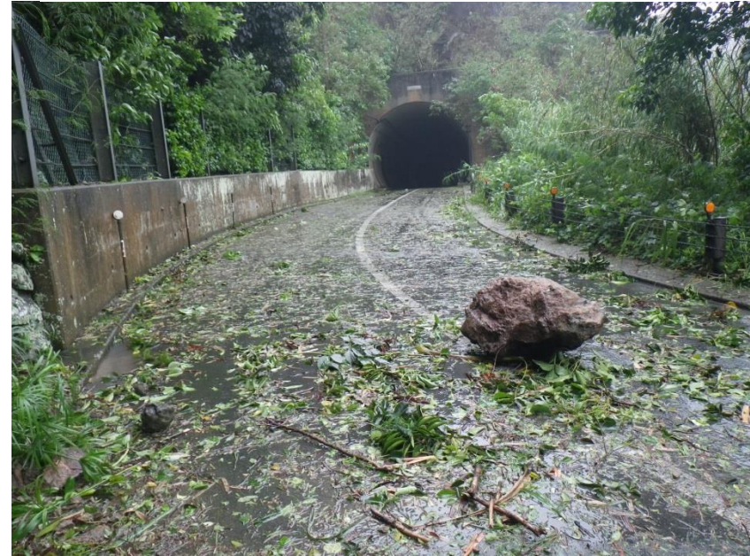
落石状況（父島 袋沢第一トンネル手前）
